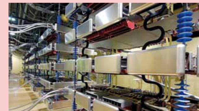
Convertisseurs commutés par les lignes (LCC) – salle des valves – © Alstom
